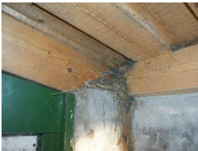
Dakconstructie binnenkant met oud vogelnest
